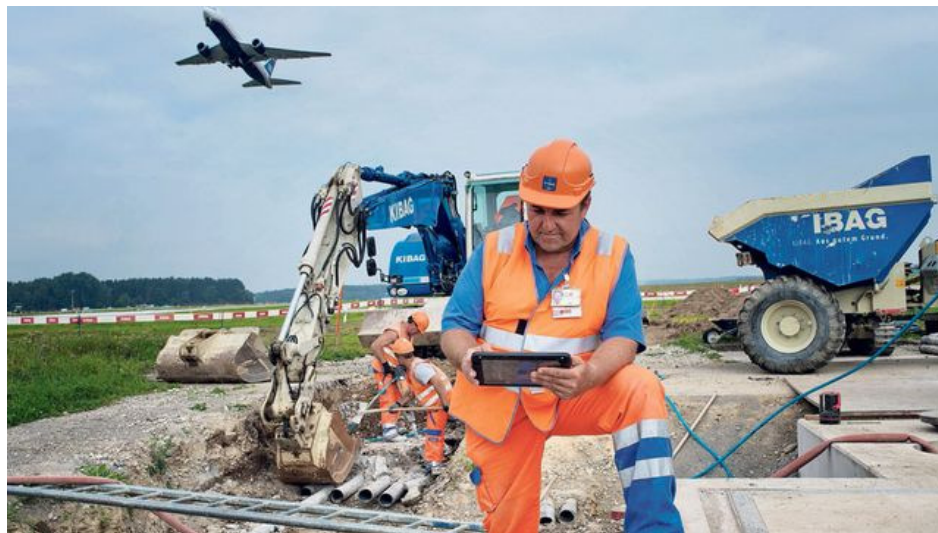
Ein Angestellter der Baufirma Kibag nutzt einen Tabletcomputer, um die Arbeiten auf einer Flughafenbaustelle zu rapportieren. (Bild: Christoph Ruckstuhl / NZZ)
