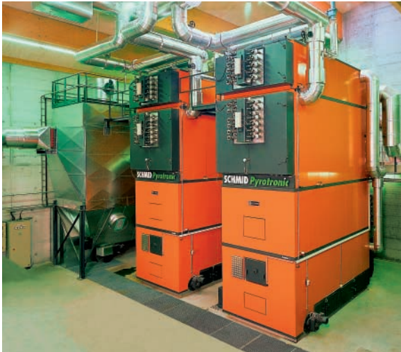
Die Doppelkesselanlage mit Elektrofilter des Fernheizwerks Wilderswil mit 6,4 MW Leistung.
